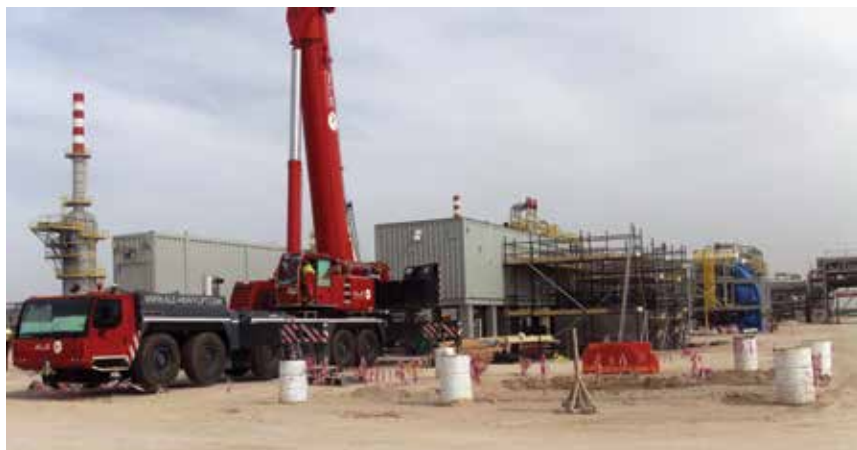
Sottostazione elettrica containerizzata. Cliente: Weatherford; Progetto: Giacimento petrolifero Zubair; Stabilimento: Eni Iraq.
