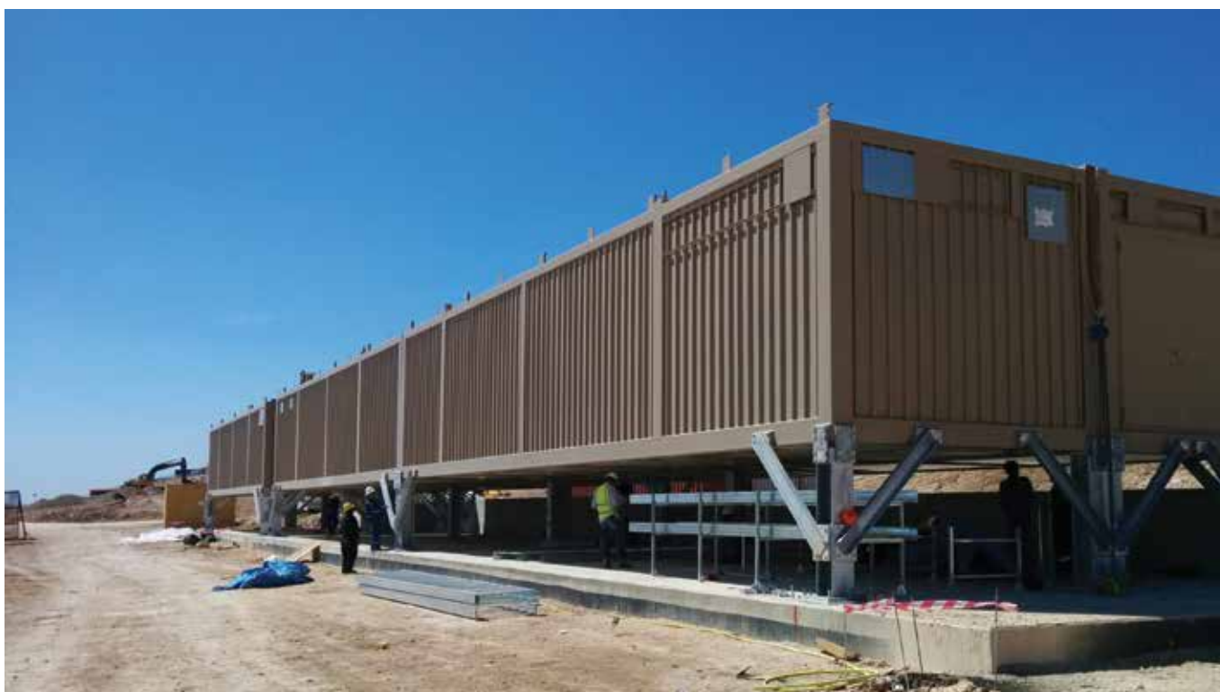
Sottostazione elettrica containerizzata. Cliente: Exterran; Progetto: progetto gas Summail; Stabilimento: Dno kurdistan - Iraq.
