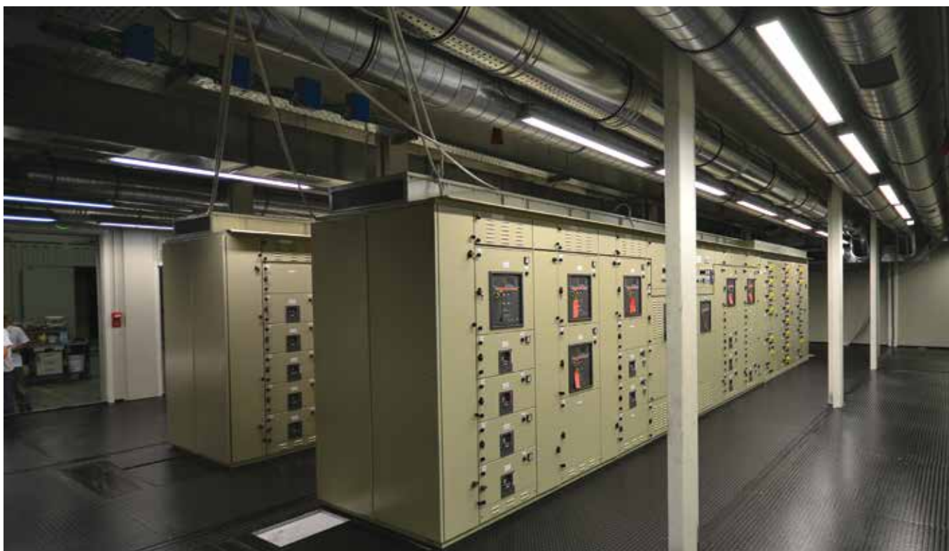
Vista interna - Stazione elettrica containerizzata. Cliente Weatherford; Progetto: Giacimento petrolifero Zubair; Stabilimento: Eni Iraq.
