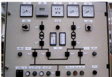
Particolare del quadro elettrico installato da IMESA sul "Gauthier"
